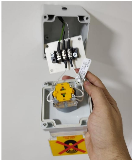
Ilustración 29 Instalación de push-botton paro de emergencia para MRI.
