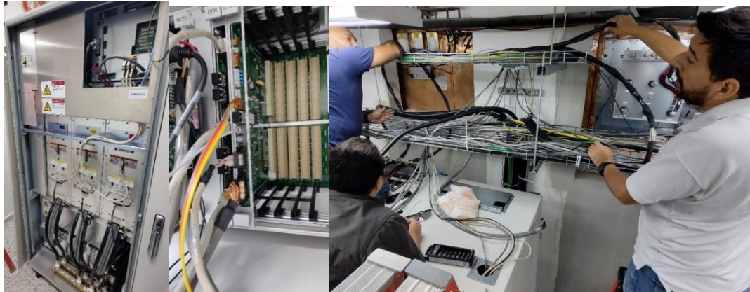
Ilustración 24 Conexiones eléctricas y de señales de RF a los gabinetes de los servidores y tarjetas de procesamiento de imagen.
