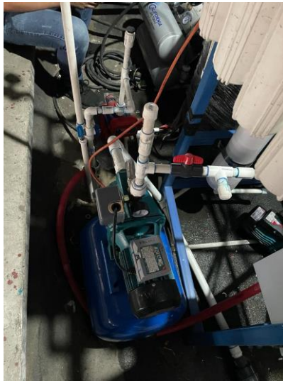
Anexo 8: Tuberías conectadas a la osmosis inversa
