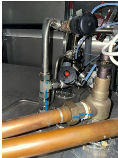
Ilustración 23: Válvula neumática S37 de escape del autoclave
