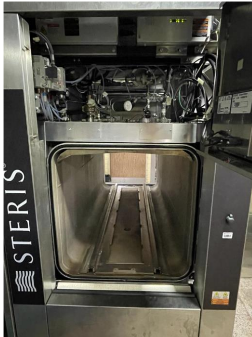
Anexo 2: Recamara y cámara del autoclave Steris AMSCO 600
