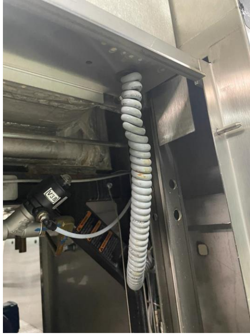
Ilustración 36: Cable de alimentación dañado
