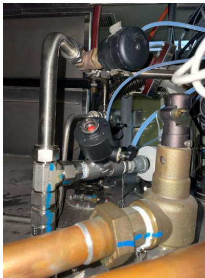
Ilustración 26: Válvulas del esterilizador Steris AMSCO 600
