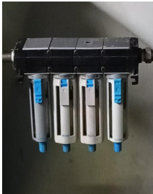
Ilustración 10. Revisión de fuga en filtros odontológicos.
