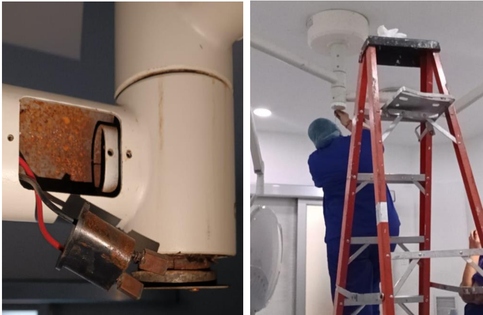
Ilustración 18. Mantenimiento lámpara cialítica Quirófano 1.
