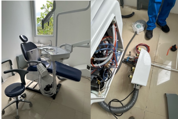
Ilustración 32: Instalación de Sillas Odontológicas
