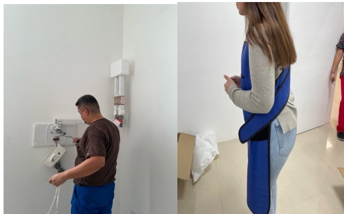
Ilustración 33: Instalación de Rayos X
