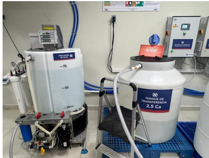
Ilustración 14: Transferencia de Ácido de Tanque de Reserva
