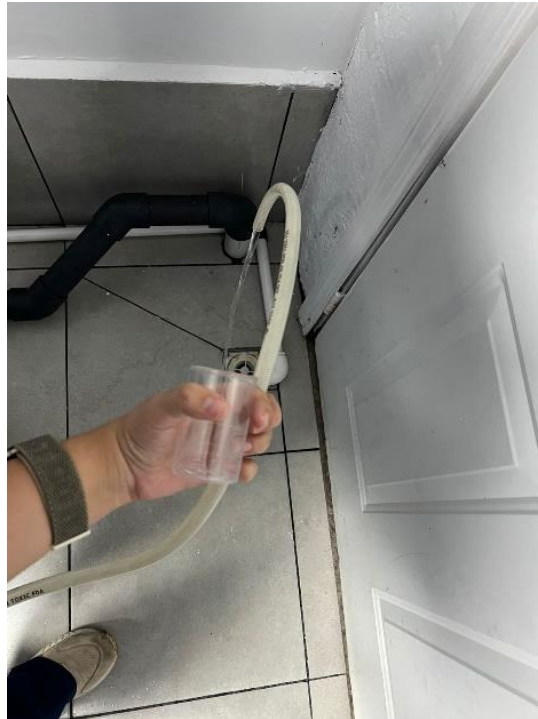
Ilustración 11: Toma de agua para prueba de dureza
