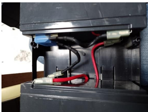
Ilustración 44 Reemplazo de batería de UPS.
