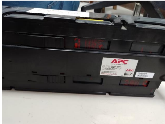
Ilustración 24 UPS del área de hemodinamia.
