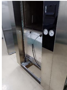
Ilustración 33 Revisión de sensores de la puerta frontal del esterilizador.
