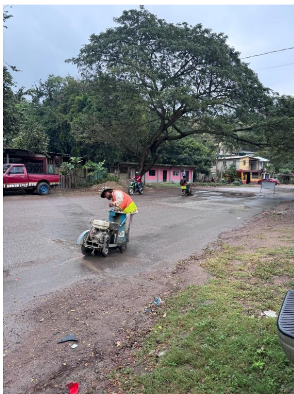
Ilustración 7 Corte de los baches marcados
