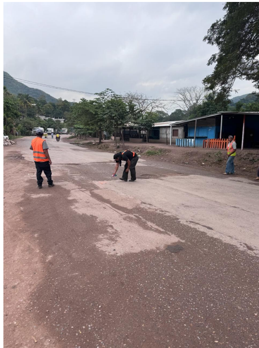
Ilustración 5 Marcaje de baches
